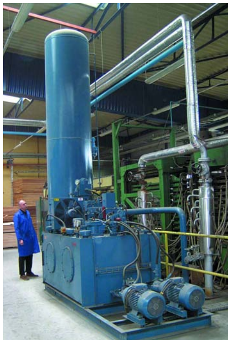
Rys. 1 Agregat hydrauliczny z hydroforem
