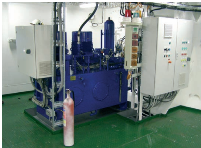
▲ Agregat zasilający z szafą sterowniczą na promie 1994/1
