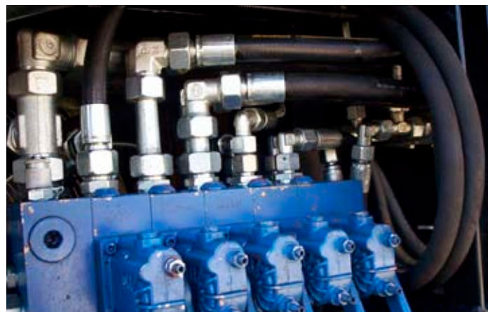
▲ Zabudowa rozdzielacza 5M4-12
