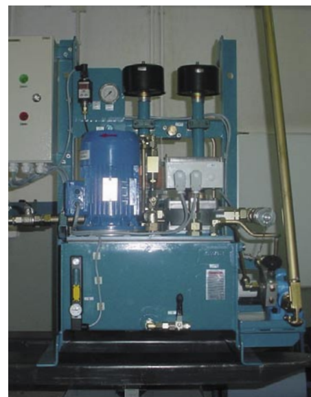
Rys. 8. Agregat uszczelnień dolnych jazu we Włocławku
