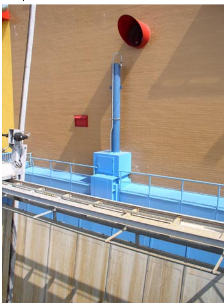
Rys. 6. Jaz „Kozielno” - napęd zasuw dla elektrowni
