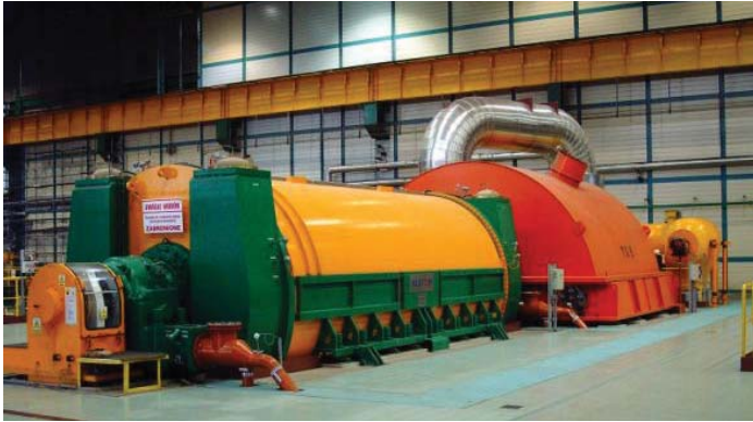
▲ Turbina na bloku TG nr 3 z układem pomp olejowych
